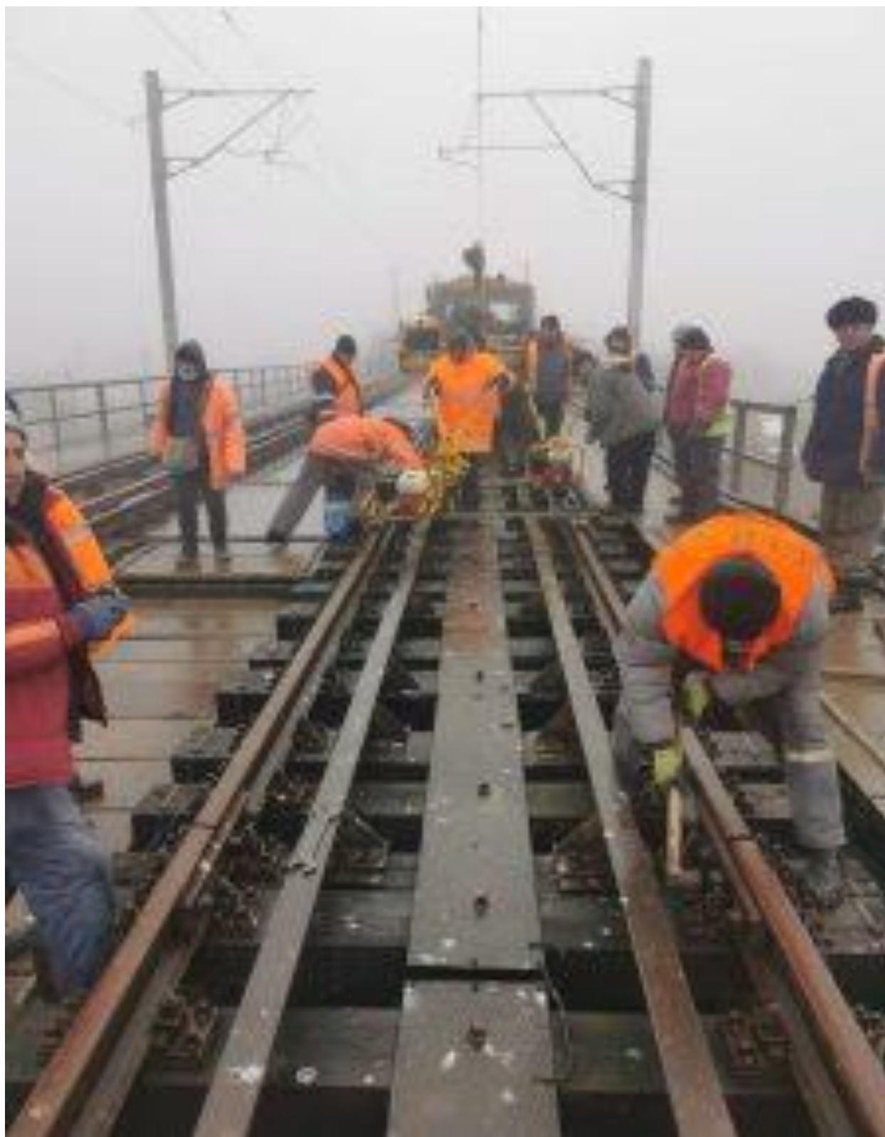
Foto: CFR Infrastructura/SRCF București/Timișoara/Brașov/Galați
