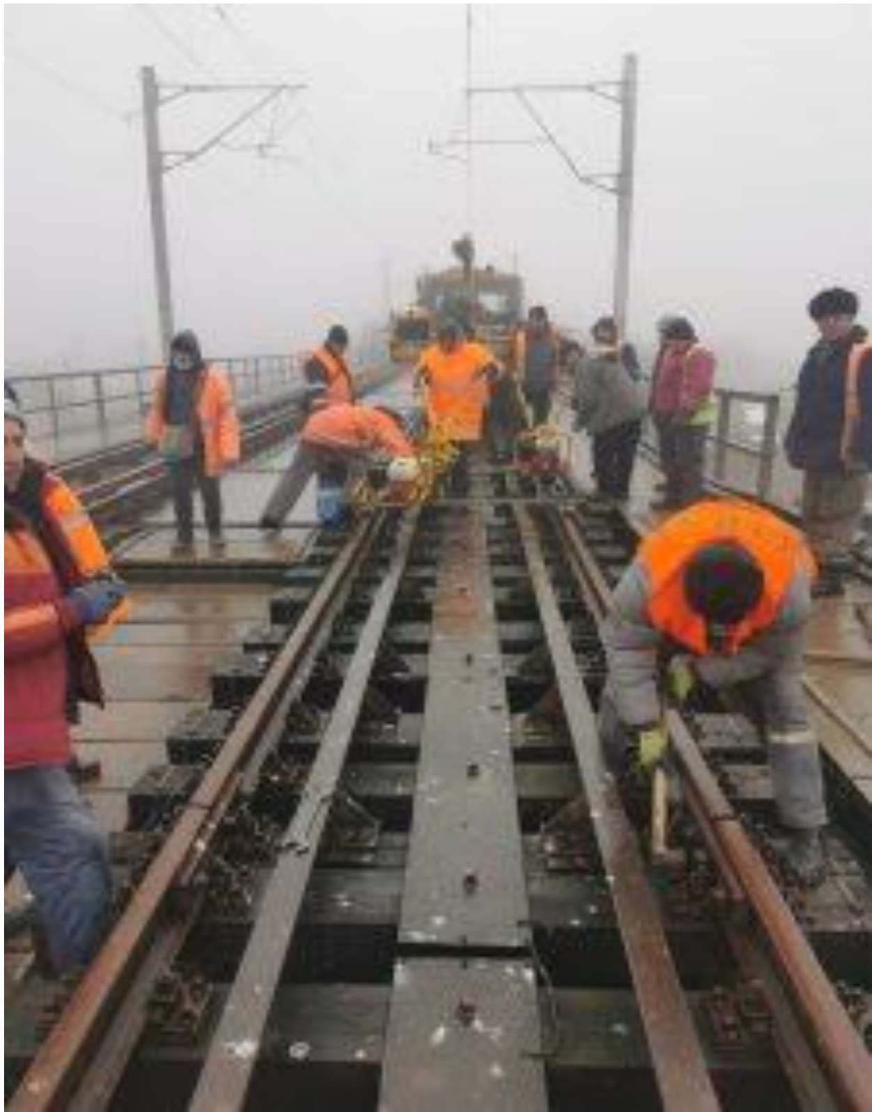
Foto: CFR Infrastructura/SRCF București/Timișoara/Brașov/Galați
